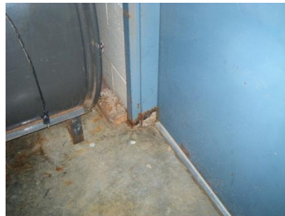
Graphic #19 – Rusting Door & Door Frame
